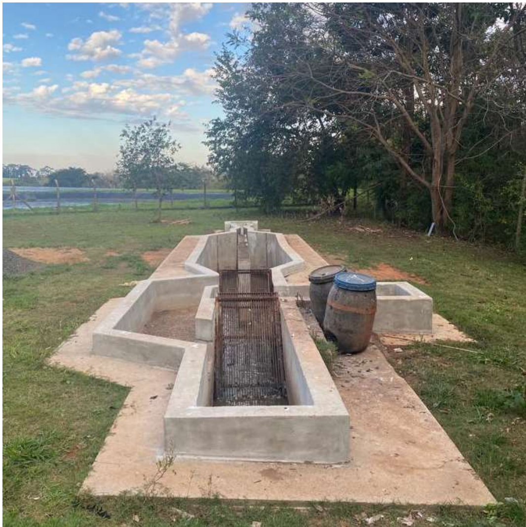
GRADEAMENTO E CAIXA AREIA CALHA PARSHAL
