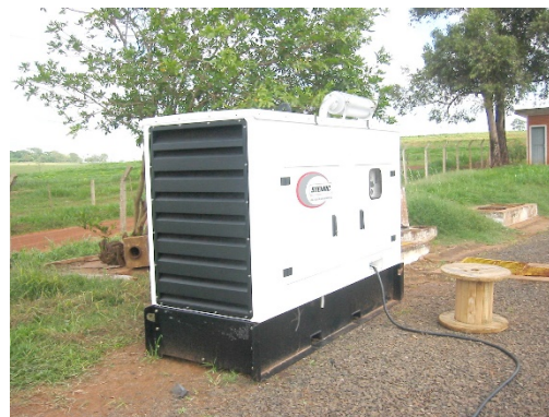
Foto 3 – Grupo Gerador 75KVA
