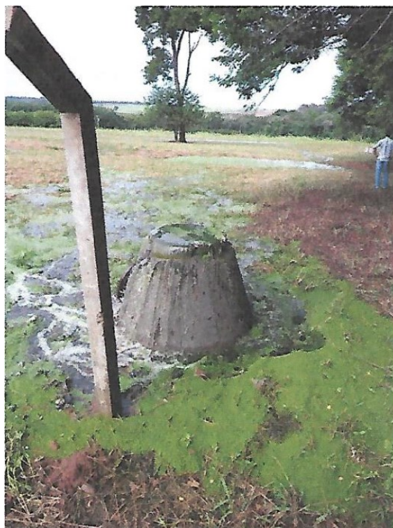
Foto 3 – Vista de vazamento em Poço de Visita existente devido ao entupimento do emissário, motivo pelo qual se faz necessário a sua substituição.
