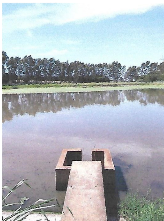
Figura 2 – Vertedouro Ajustável, saída do esgoto tratado da Lagoa Facultativa lançado através do emissário existente no afluente do Ribeirão das Palmeiras.
